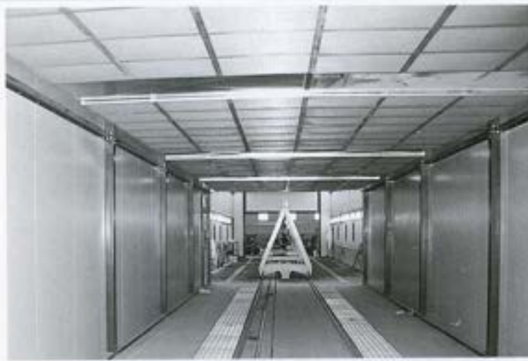
Fig. 17 - Il carrello dei pezzi accessori, verniciati con fondo e finitura all'acqua, lascia la cabina di spruzzatura (sul fondo in figura) per posizionarsi nel forno di cottura. Dopo il suo ingresso, le porte a serranda si chiudono automaticamente per portare a termine l'indurimento dei due strati di vernice all'acqua
