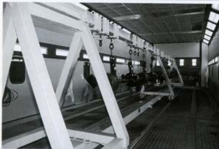
Fig. 6 - Particolare dell'interno cabina con il carrello portapezzi, già verniciati con fondi e smalti all'acqua, in movimento verso il forno di cottura vernici a circa 90 °C
