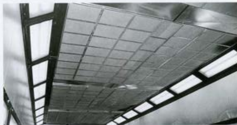
Fig. 10 - Particolare dell'illuminazione interna ottenuta con tubi fluorescenti contenuti entro plafoniere in esecuzione IP 65. Esse sono posizionate sugli angoli superiori e sulle pareti laterali per garantire un'ottimale distribuzione della luminosità
