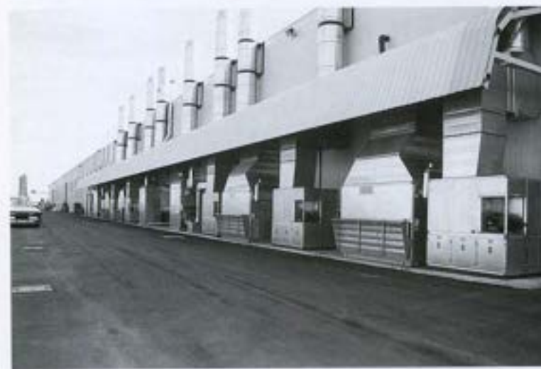
Fig. 12 - Vista generale dei gruppi di aspirazione e filtrazione aria posti all'esterno dello stabilimento
