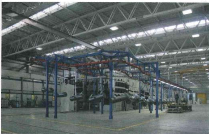
7 - Vista generale degli impianti di verniciatura. General view of coatings systems.
